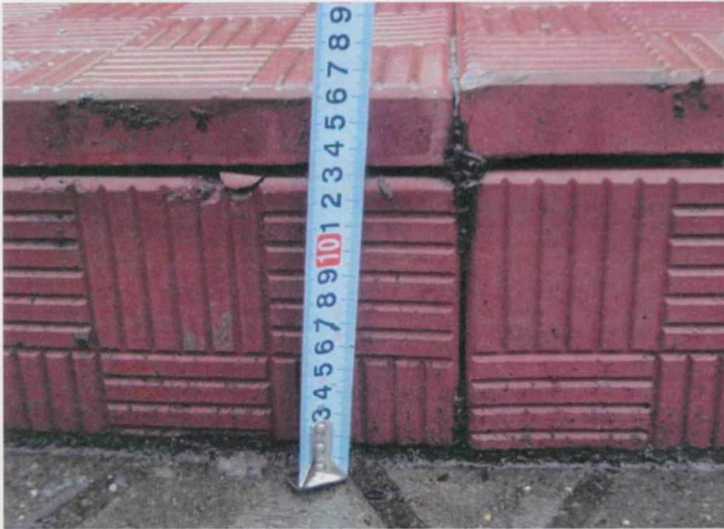
Высота первой ступени наружной лестницы цокольного этажа 1 секция
