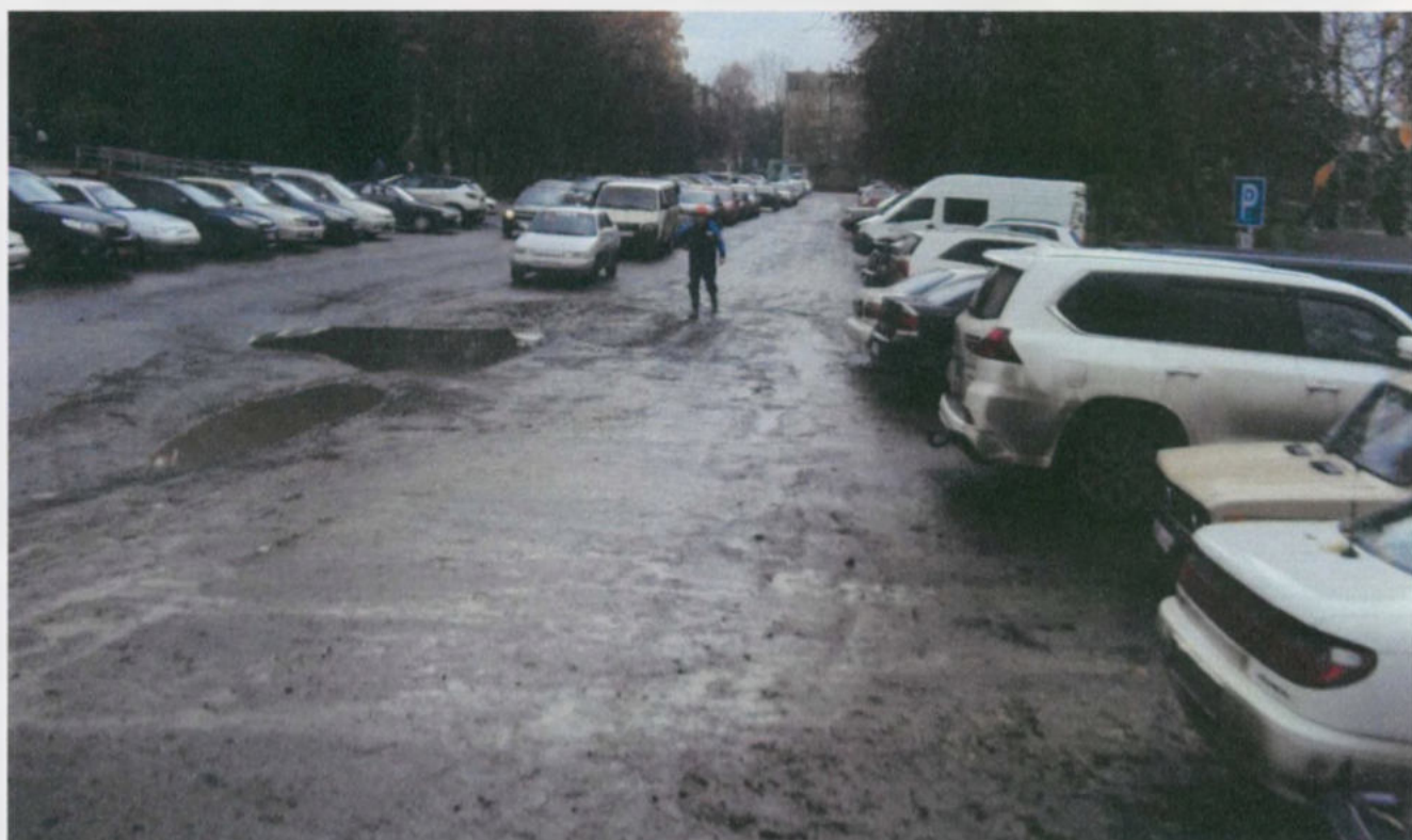
Путь следования от парковки для МГН через проезжую часть (имеются повреждения покрытия дорожного полотна)
