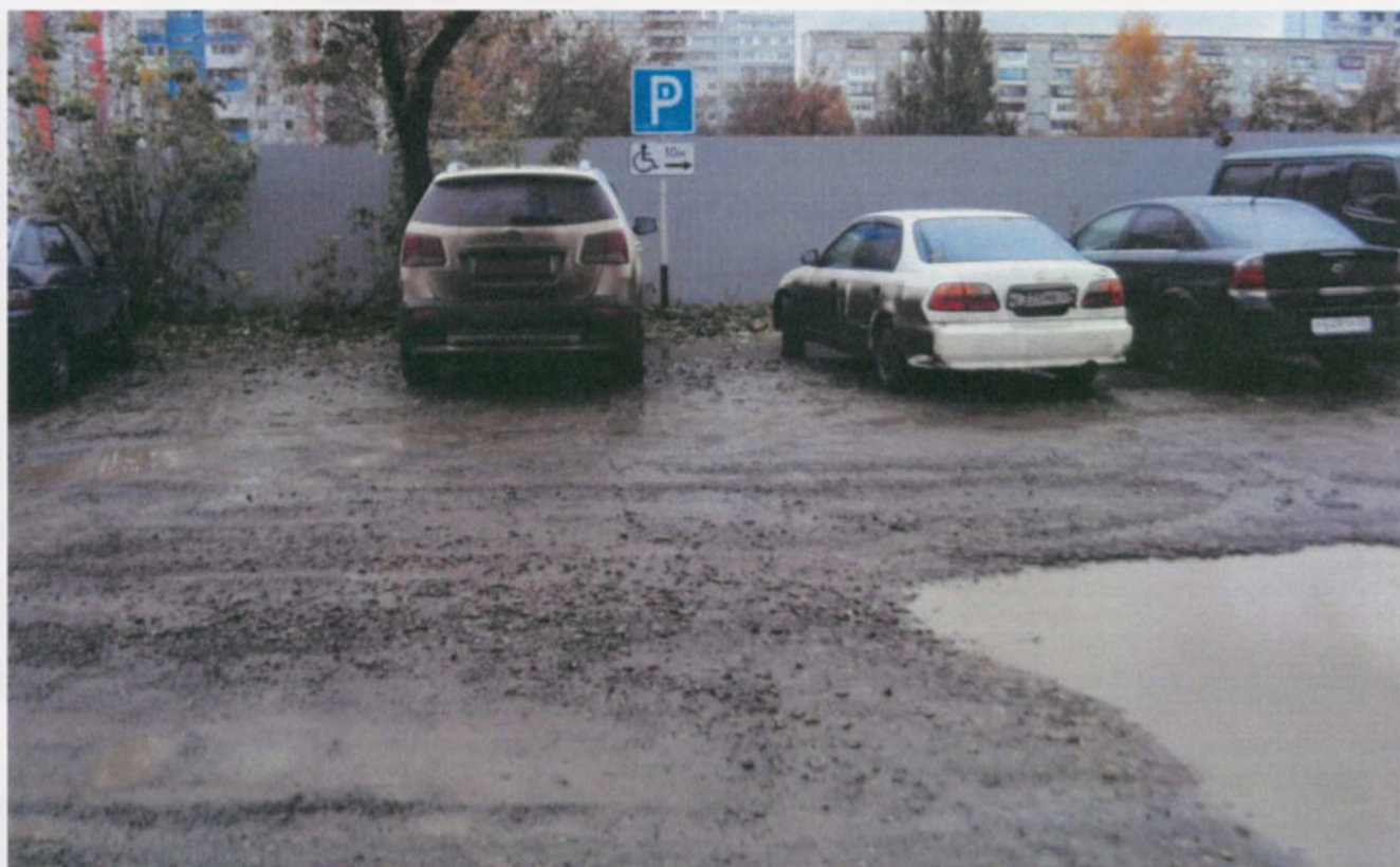
Парковка для МГН размещена на нетвердом покрытии (грунт) Имеется возможность перенести парковку ближе в наружному пандусу цокольного этажа
