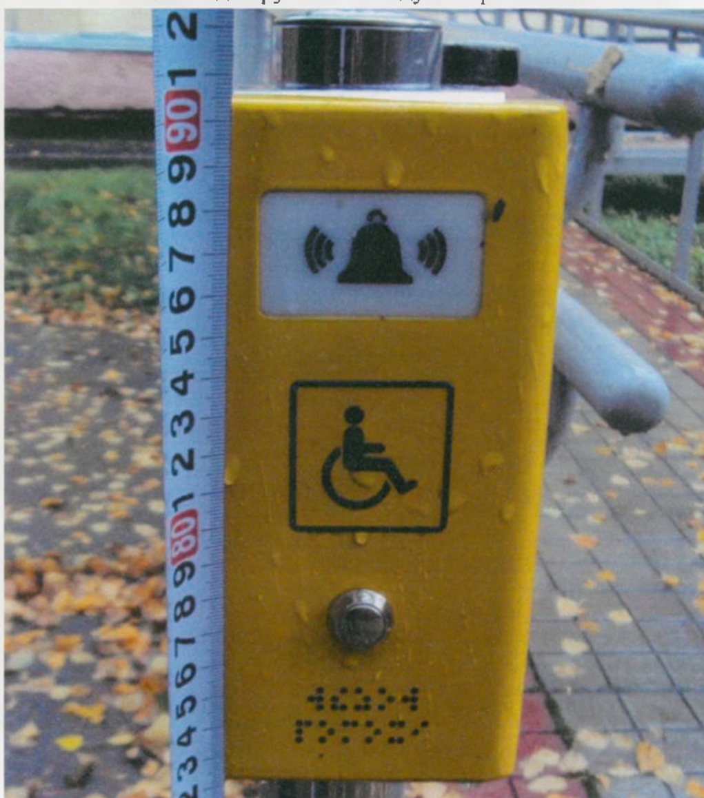
Кнопка вызова помощи персонала пандуса первого этажа (высота установки)
